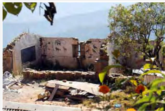
14 De school in Dolakha District blijkt erg getroffen door de aardbeving...
