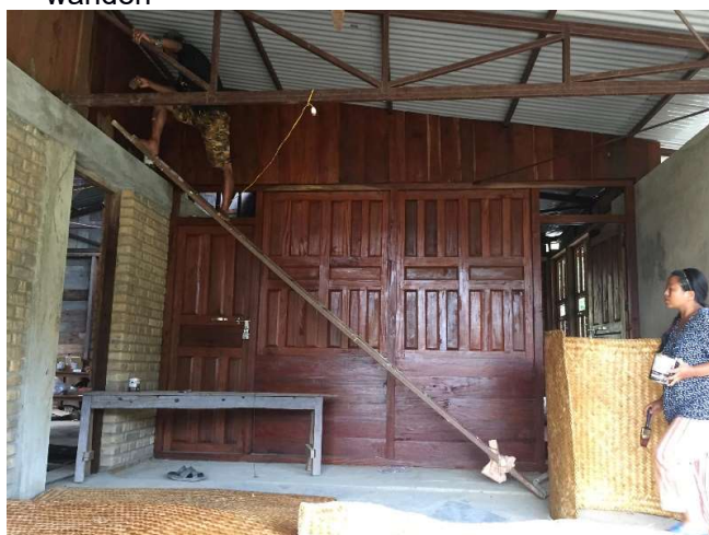
Zicht op schrijnwerk naar de keukenklas vanuit de (overdekte) buitenklas. Werken aan het binnenschrijnwerk en de afwerking van de plafonds (met matten) in uitvoering
